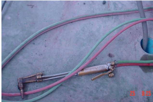
ภาพที่ 2 หัวเชื่อมแก๊สที่ไม่มีอุปกรณ์ป้องกันไฟย้อนกลับ (Flashback arrestor)
