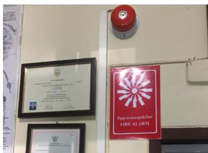
รูปที่ 6. ระบบสัญญาณเตือนเพลิงไหม้
