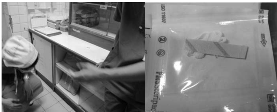
รูปที่ 2 (ซ้าย) ชั้นล่างของตู้เก็บอุปกรณ์ปลอดเชื้ออยู่สูงจากพื้นไม่ถึง 20 ซม.
