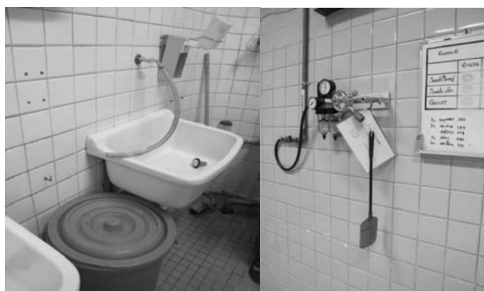
รูปที่ 1 (ซ้าย) อ่างล้างมือและถังเก็บน้ำสำรองบริเวณข้างห้องผ่าตัด
