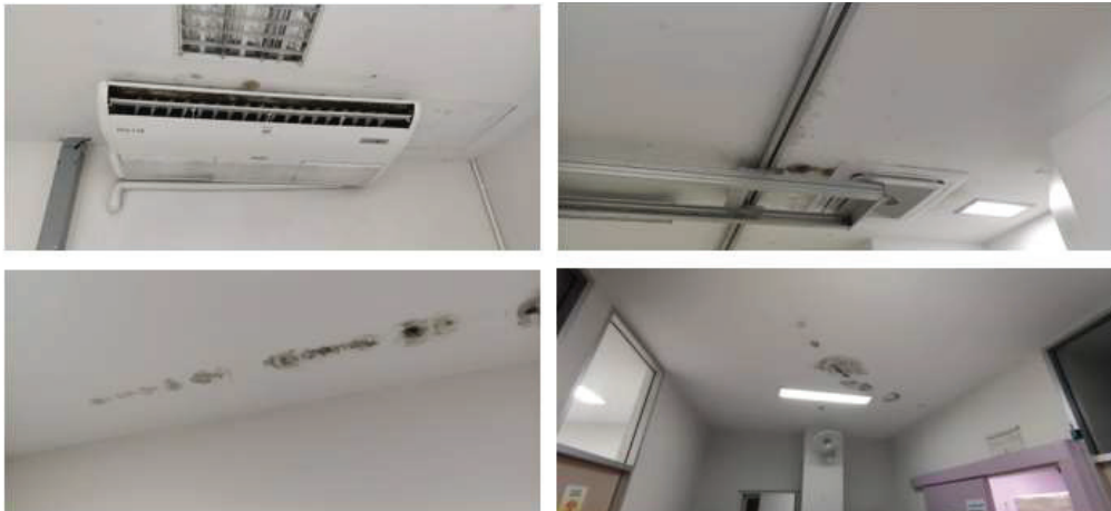
ภาพ 2 แสดงเชื้อราที่บริเวณฝ้าเพดาน ผนังห้อง และ บริเวณเครื่องปรับอากาศ
