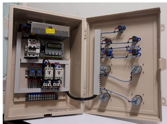
ภาพ 11 แสดงกล่องควบคุมการทำงานภายในโรงเรือนปิด
