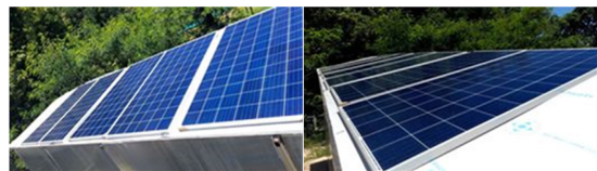
ภาพ 8 แสดงลักษณะแผงโซลาร์เซลล์ที่วางบนหลังคาทรงจั่วทำมุม 15 องศา ข้างละ 6 แผง
