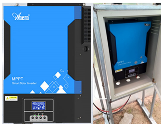
ภาพ 9 แสดงการติดตั้งและการต่อระบบ Hybrid off grid inverter 5.5kw.
